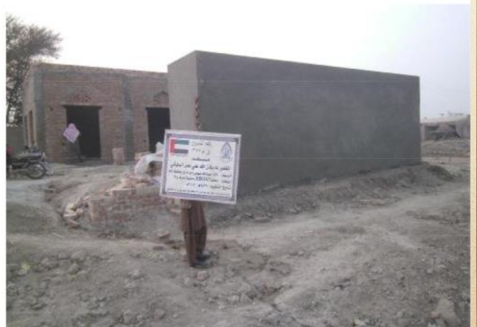
مشروع بناء بيت في الجنة / مسجد المغفور له بإذن الله عمر البلوشي (ق/م ٢٧٢)
